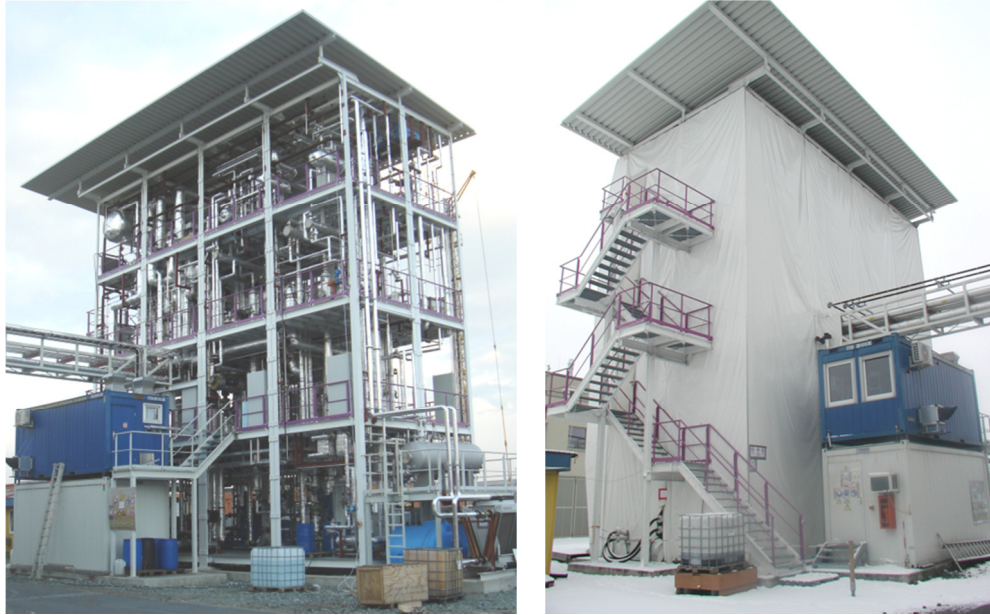
Abbildung 6: 1MW BioSNG Pilot- und Versuchsanlage
